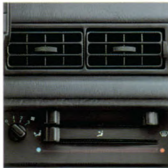
Verwarmings- en ventilatiesysteem met 3-traps ventilator.
