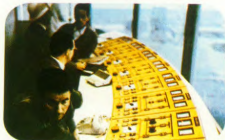
Rubber. Wat lijkt op de controlekamer van een luchthaven, is in werkelijkheid een paneel waarop de productie van rubber wordt gecontroleerd. Een vrijwel geheel geautomatiseerde fabriek in Nantes.
